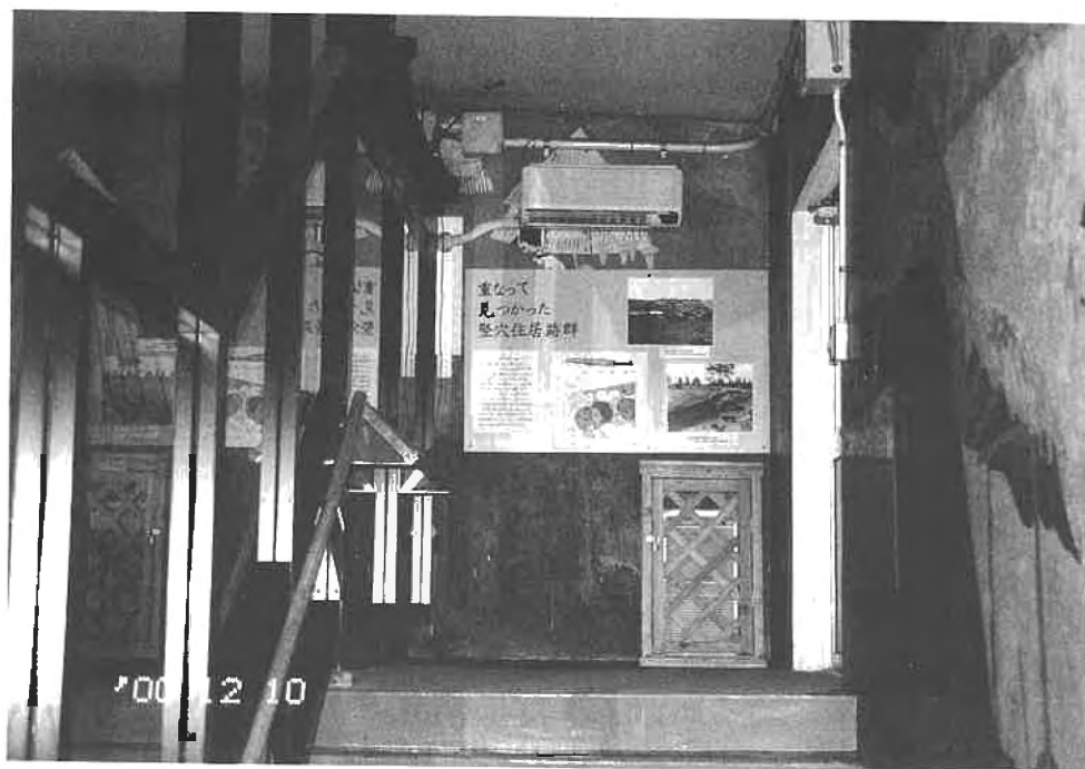
図 2. 導入された、除湿器と空調装置
