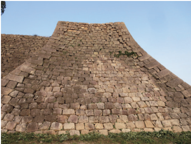
図5 石垣毀損状況
