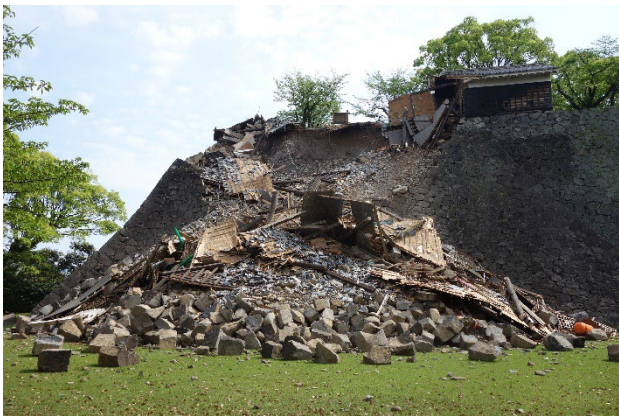
第 2 図 北十八間櫓崩落状況
