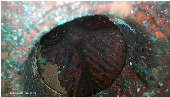
図16 笠裏側の空洞状態
