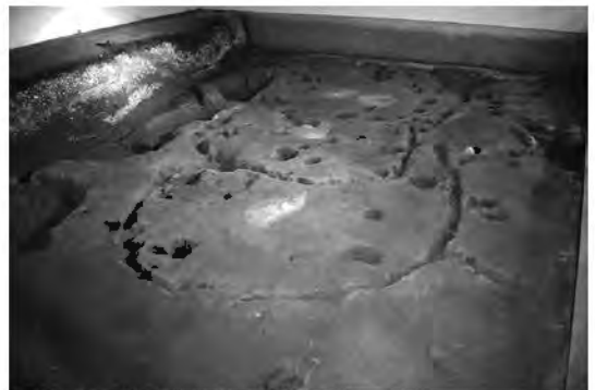
写真 9 地衣類の発生状況③
