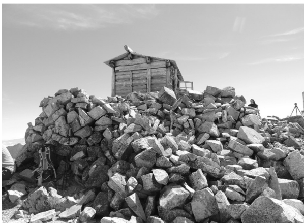
西側石積みの崩落状況
