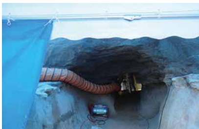
3. 排気ダクトの設置状況(入口)
