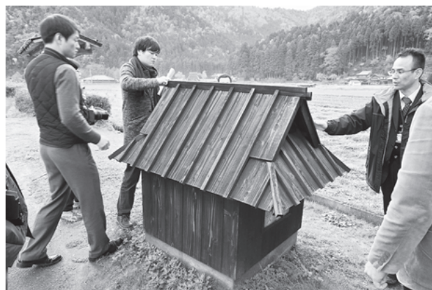
図 I -86 放水銃格納庫 (美山町)
