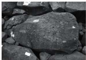
写5-8-4 玉ねぎ状の破断石材(施工前)
