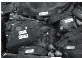
写5-8-12 すべり・詰石破損 (施工前)
