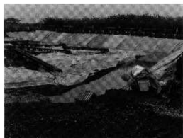
II区 降雨・涌水による調査区水没状況
