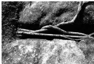
写真6 C11SD1 木の根が入り込んでいる状況
