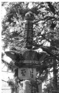
相輪の折れの補強状況（修復前）
