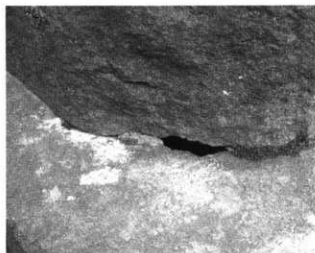
基壇2段目 中空状況
