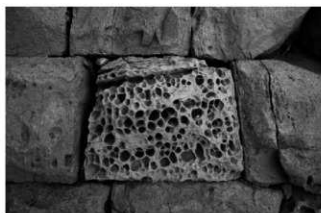
2区石堤表法構築後浸食石材（西から）
