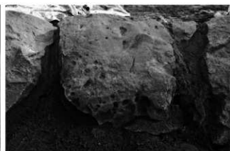
2区石堤裏法構築前浸食石材（西から）
