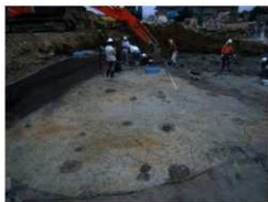
③6/4 小さな穴を検出しました。
