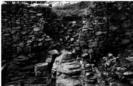
(1) 百間石垣 36次石垣北半B工区崩落部 (南東から)
