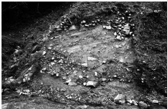
(1) 小石垣 A-1地点 崩落部 (東から)
