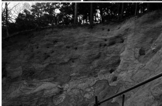
(4) 東側土塁 大谷東方地区 B 区 土塁崩落部土層（東から）
