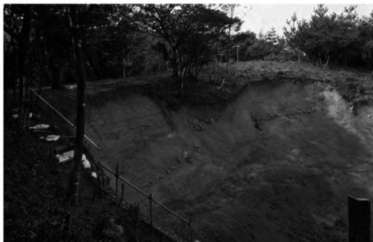
(1) 北側内周土塁 小石垣東方地区 A 区 土塁崩落部土層（東から）
