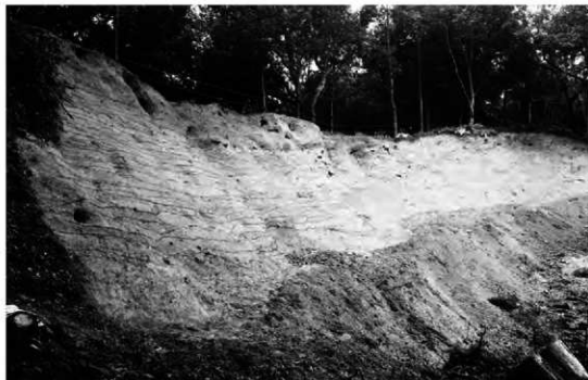
(1) 北側外周土塁 小石垣北方地区 A 区 土塁崩落部土層 (南東から)
