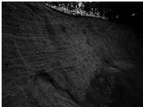
(1) 東側土塁 原地区北地区 土塁崩落部土層（北東から） （太宰府市教育委員会提供）
