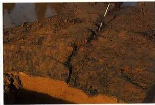
H-40 地割れ断面
