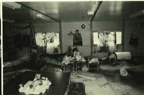
2. 床の抜けた作業員棟内部
