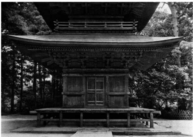
23 修理前 初重軒裏及廻縁（西面）
