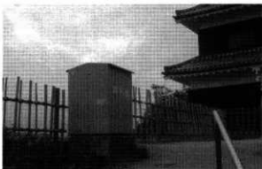
⑧ 消火栓 (放水銃) と転落防止柵
