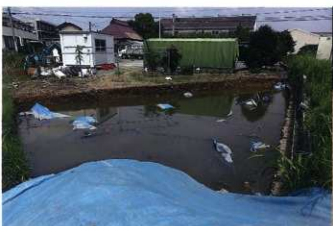
大雨による現場の水没（西より）
