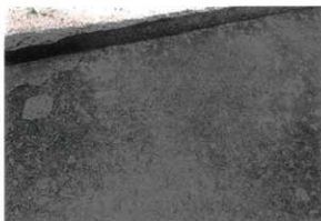
写真36 5区凹み検出状況
