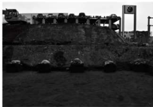
B区 S-14~S-18横出状況(西)
