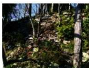
西の丸1石垣 樹木が生えている (⑨)
