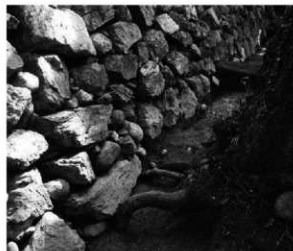
Fig.48 西面埋もれ隅角
