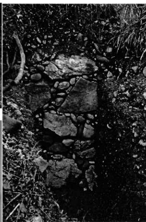
Fig.52 大手道石垣埋没状況
