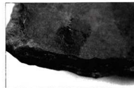
▲塗膜が剥離し始めている箇所
