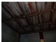
[写真 4-29] 女中部屋 天井雨漏り跡
