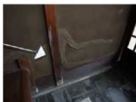
[写真 4-28] 玄関 左官壁一部毀損
