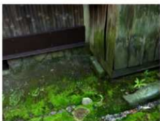
[写真 4-7] 主屋東石の欠損・移動 (北東庭)
