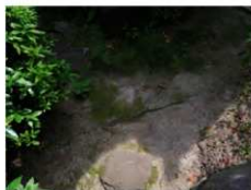
[写真 4-8] 飛石周辺の土砂堆積 (北西庭)
