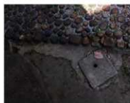
〔写真 4-3〕表土の流出・補修（中庭）
