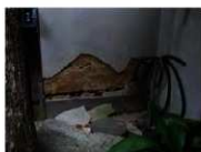
〔写真 4-22〕東高塀 小壁左官亀裂
