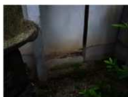
〔写真 4-21〕北高塀 壁剥落
