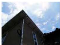
〔写真 4-27〕屋根 上屋根樋毀損、樋塗装全体的に毀損
