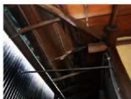
[写真 4-31] 垂木 蟻害
