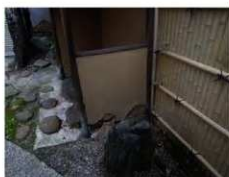
[写真 4-32] 左官袖壁腐朽
