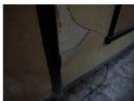
[写真 4-30] 壁面 土壁毀損
