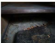
[写真 4-33] 土間三和土割れ
