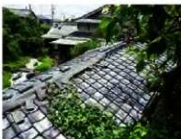
〔写真 4-25〕棟瓦、平瓦、軒瓦のずれ、ツタ等の繁茂が屋根土に到達
