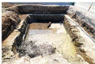
③ 4次堆積状況
