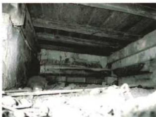
写真 6-13 643A 便所付近床下(左:便所 右:室内)
