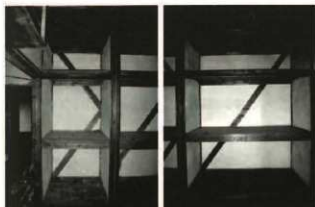
写真 6-24 “く”の字筋かい
