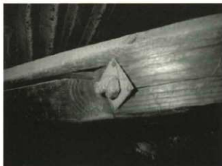
写真 6-50 ボルト締め火打梁
