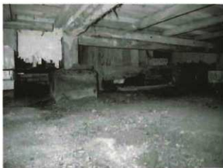
写真 6-15 642A 半壊な土壁の最下部
