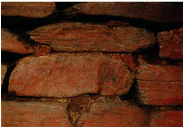
日貼り粘土付着状況
