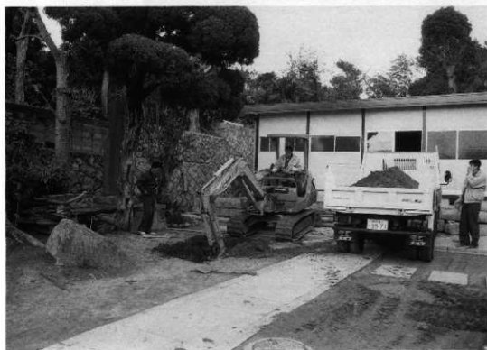
震災により寺院本堂が全壊した調査地近景 第2トレンチ掘削状況（南東から）
