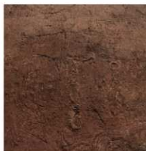
床下コンクリート「縄目」痕
