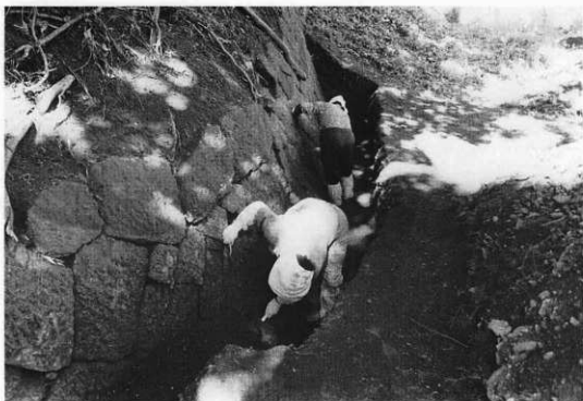
E地点根石調査状況
