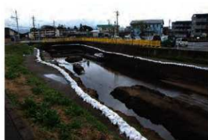
調査区水没状況
