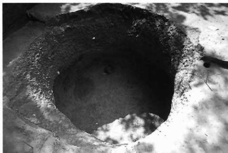
1. 底面に土留の剥離を発見した。
