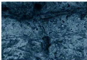
SD-67 水止め跡か (南から)
