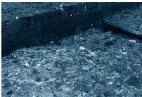
S1-9 南東隅隆起状況(北西から)
