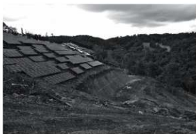
太陽光パネル設置状況（南から）
