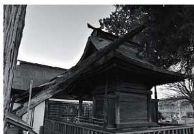
松尾神社本殿 倒木状況
