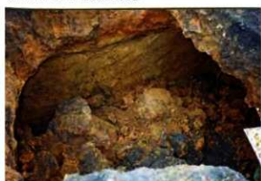
S K 655 天井崩落状態
