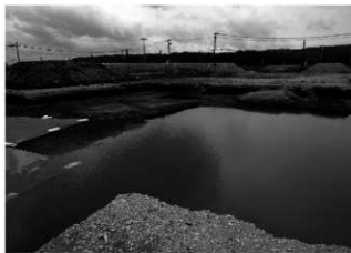
2. C区 水没状況(北西→)
