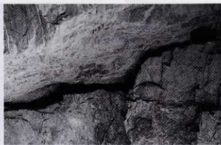
洞穴天井の亀裂 (1)
