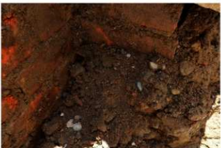
外壁接地部の砂混じりの土
