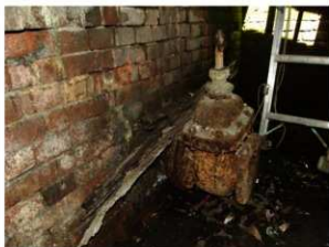
西側(駅方向)給水バルブ 横方向
