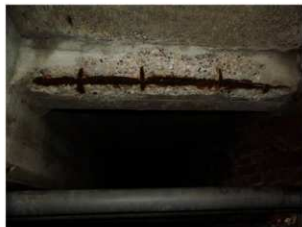
コンクリート構造物 劣化状況
