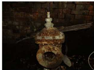
西側(駅方向)給水バルブ正面
