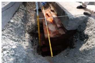
深さ約 1m コンクリート厚さ 300mm コーナーレンガ1個幅半分外へ出る
