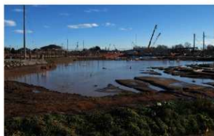
7 D区水没状況
