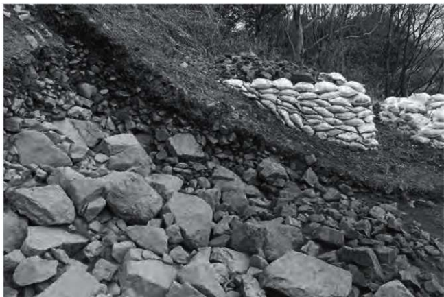
石垣 SW020101 崩落石堆積状況
