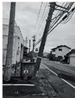
第28図 液状化で沈んだ電柱 (能登半島地震 新潟市西区)
