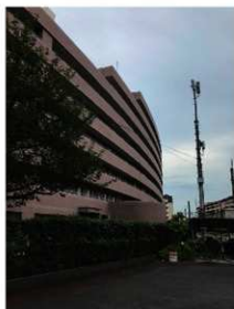
第98図 建物外壁が歪曲したマンション
