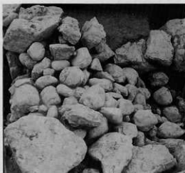
閉塞状況(左が支室)
