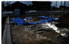
写真1-3 2区水没状況（西から）
