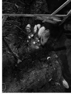
⑥工事立会の石積み護岸遺構検出状況(西端部・北東から)
