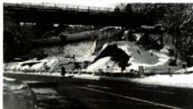
Fig.12 白鳥堀調査区壁面崩落状況
