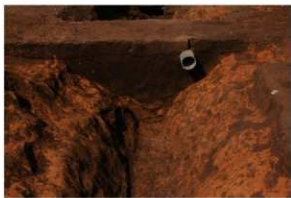
第88号沟迹覆土堆积状态
