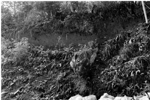
対象地の崩落状況（東より）
